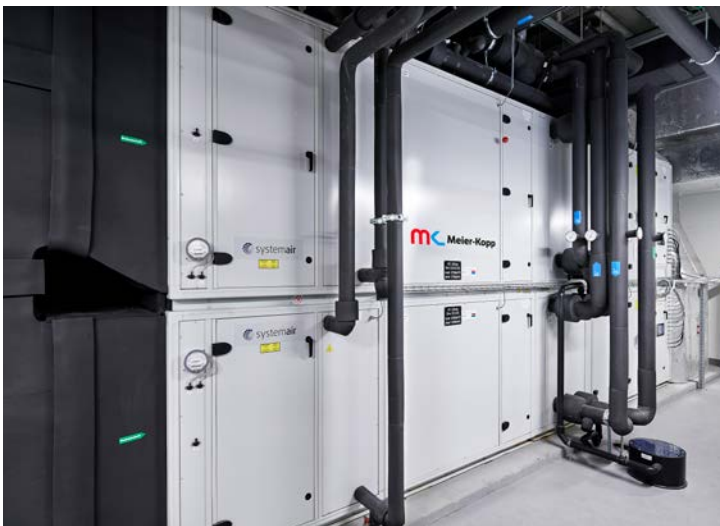
Lüftungszentrale eines Geschäftsbauwerkes
